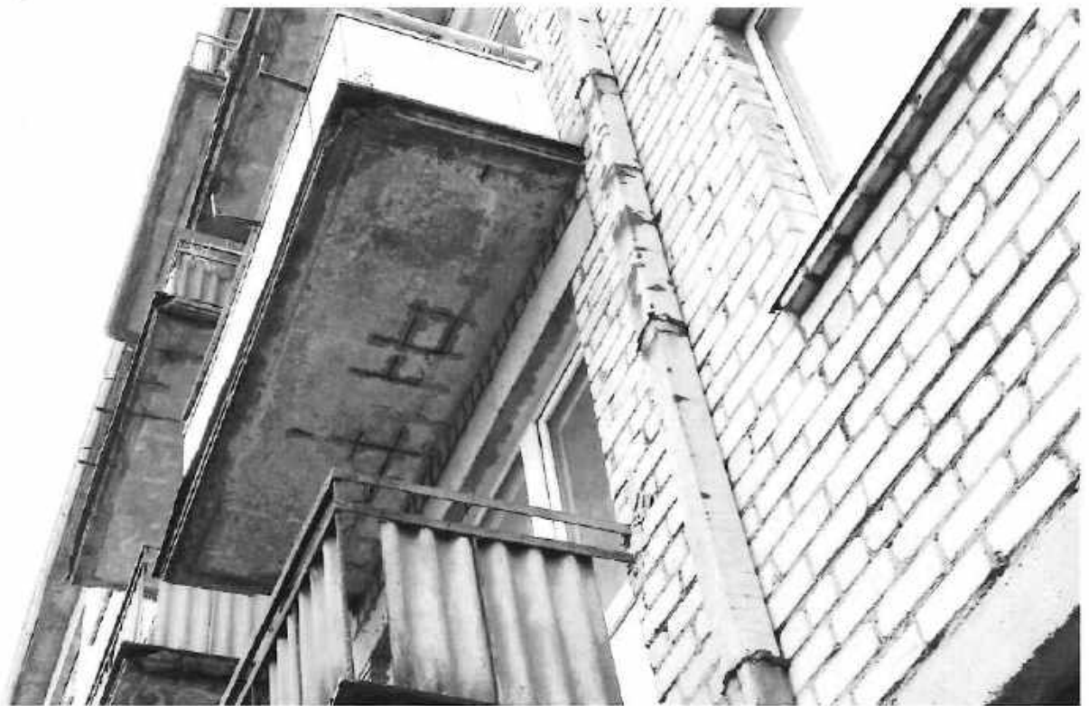
5pav. Nutrupėjusios balkonų apačios.
