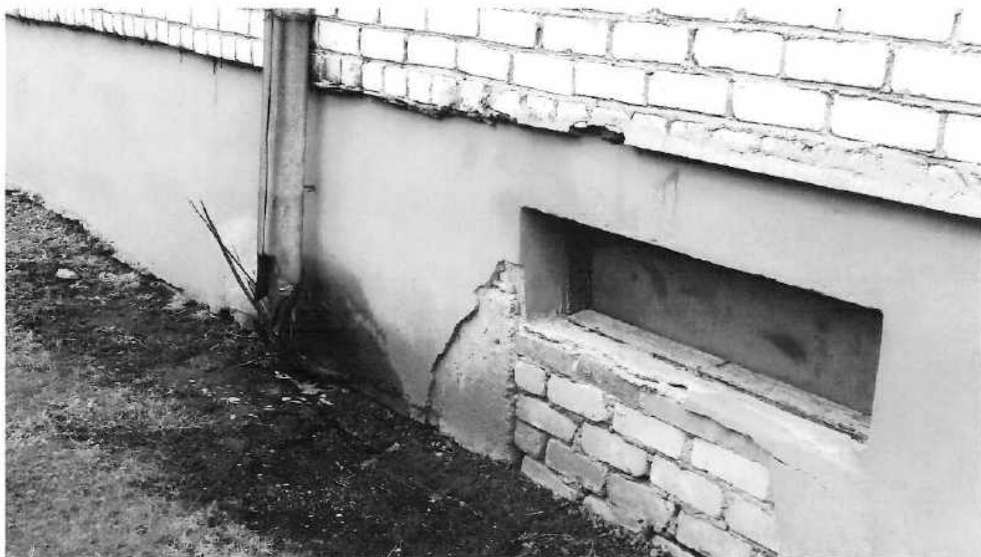
6 pav. Seni rūšio langai, cokolis įgeria drėgmę per suardytą nuogrindą.
